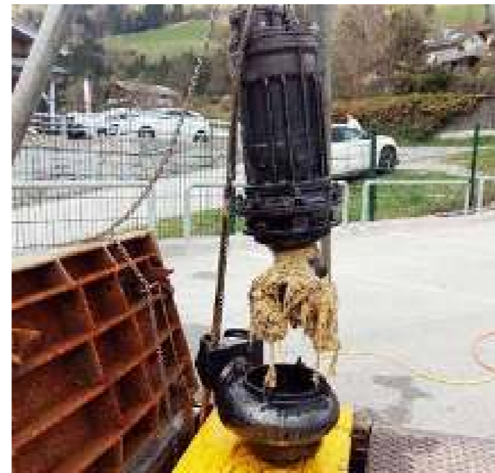
Verstopfung Pumpwerk in der Gemeinde Taxenbach
